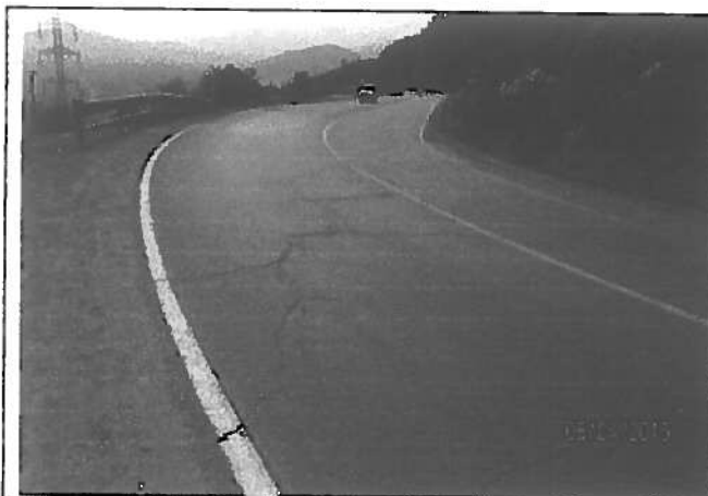
Fotografía N°89 (08.04.2015) Grieta longitudinal y transversal, calzada cuesta El Melón, km 132.
