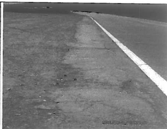
Fotografía N°90 (08.04.2015) Berma deteriorada, cuesta El Melón, km 132.
