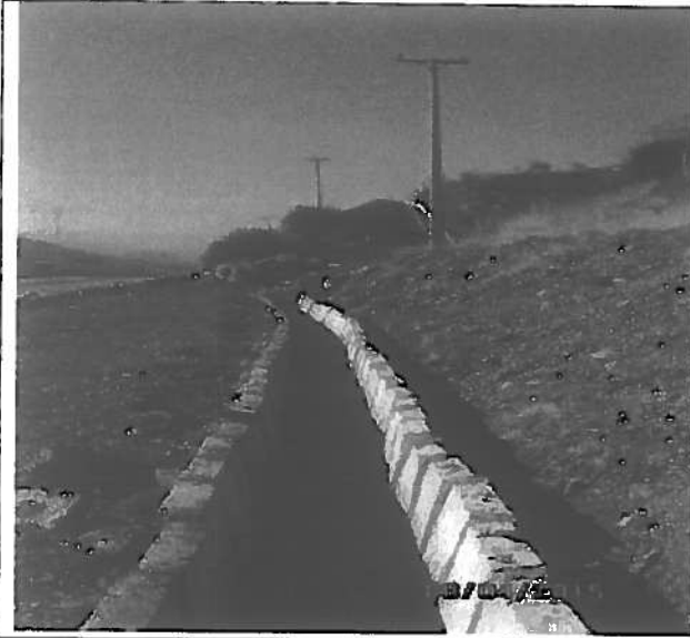
Fotografía N°13 (08.04.2015) Foso revestido con paredes desalineadas, km 74,3, cuesta Las Chilcas.
