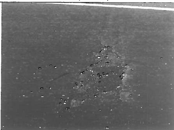
Fotografía N°94 (08.04.2015) Bacheo mal ejecutado, calzada cuesta El Melón, km 133.
