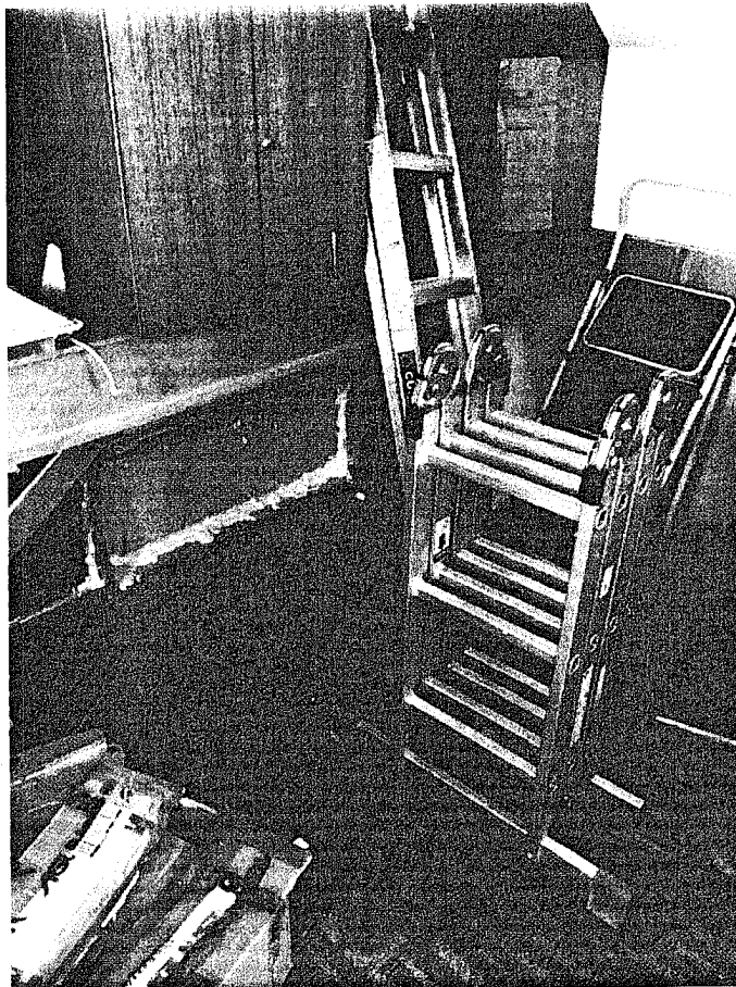
Fotografía N° 10. Equipo EV-01 de clima no instalado en nivel técnico de la torre de control.
