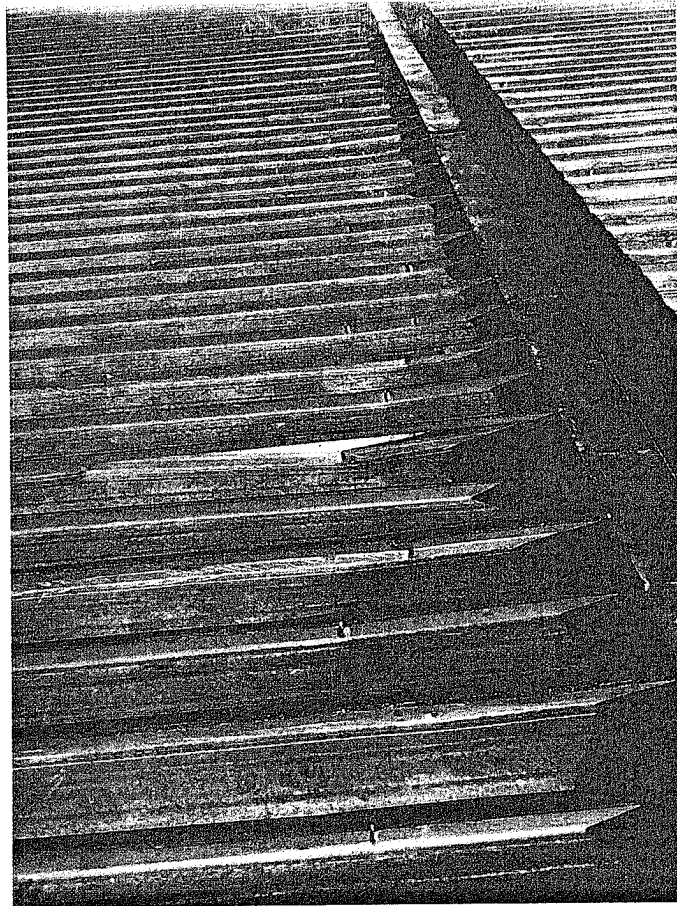
Fotografía N° 13. Planchas de la cubierta con deficiencias en las uniones.
