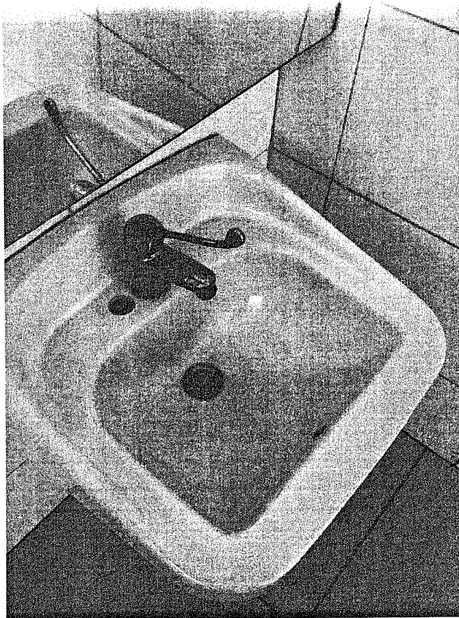
Fotografía N° 11. Grifería de baño N° 25 sin temporizador.
