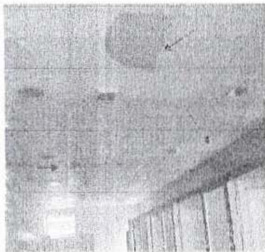
Foto N° 14: Filtración de cubierta se manifiesta en manchas en cielos.
