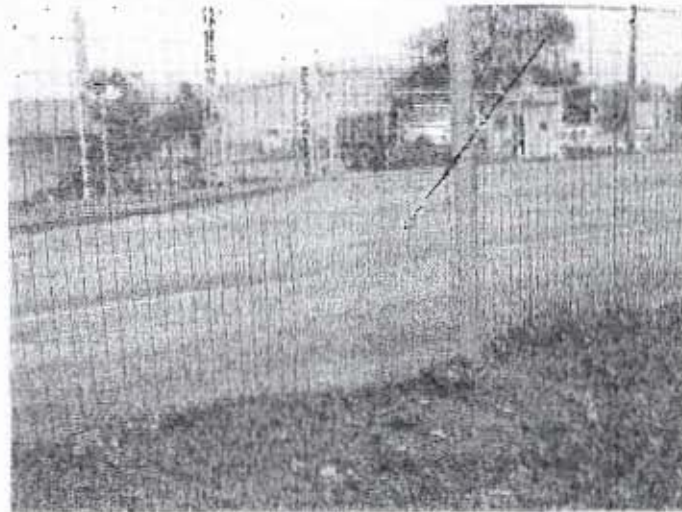
Fotos N o 3 – 4 – 5: Falta de cierre facilita cruce de peatones y el ingreso de animales a la vía.
