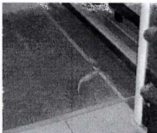
Foto 12. Desprendimiento de bordes de alfombra en nivel 4,20
