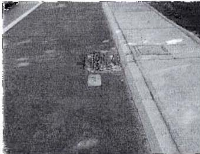
Foto 27. Acumulación de basuras y desperdicios en sumidero de aguas lluvia de calle de acceso.
