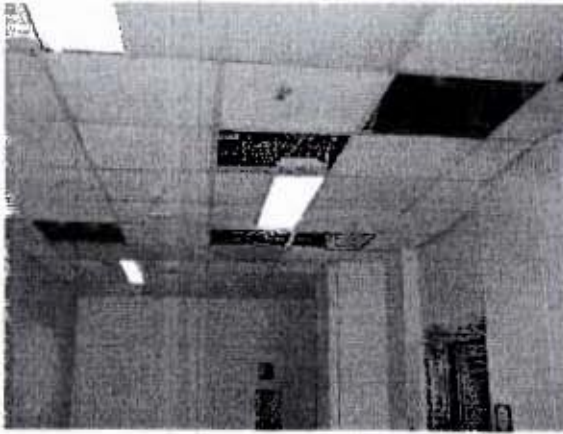
Foto 5. Falta de palmetas en cielo falso de nivel 4,20.
